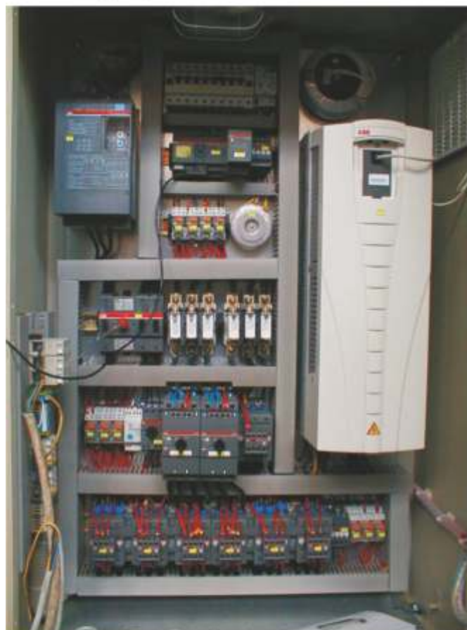
Fig. 1. Vedere a interiorului dulapului AER 2x30+5,5
